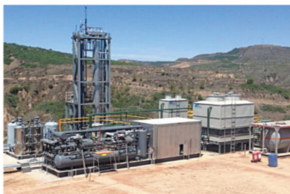
30,000m 3 LNG liquefaction semi-sealed MRC unit
