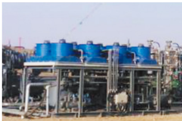
50,000m 3 LNG liquefaction semi-sealed MRC unit
